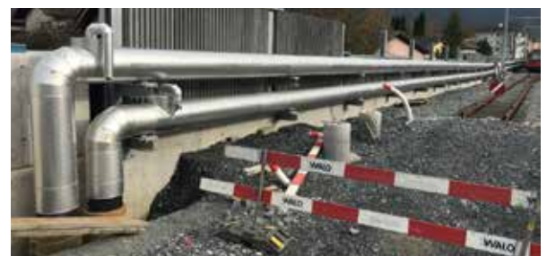
Ansicht Fernwärmeleitung an Lärmschutzwand
